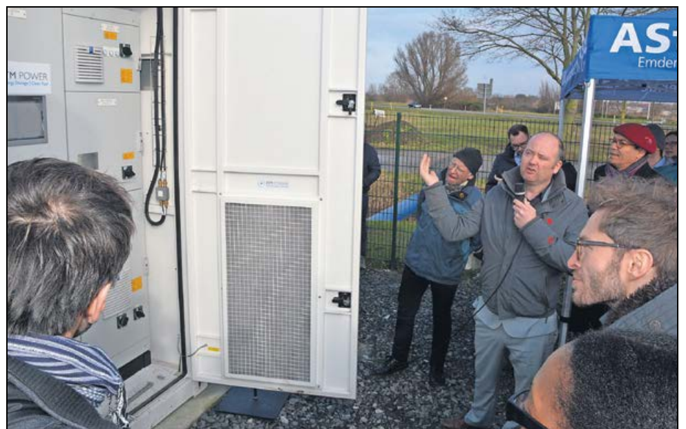
Ben Green von der Firma ITM Power aus Großbritannien erklärte den rund 50 Fachleuten gestern die Power-to-Gas Anlage in der Pfälzer Straße. EZ-Bild: Tammen
