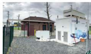
SISTEMA REALIZZATO AD EMDEN
